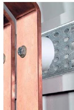
Изолятор крепления силовой сборной шины
